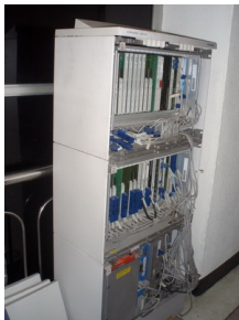
Abbildung: Ericsson MD110 Telephone Exchange
